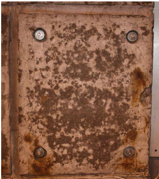
Abb. 25 Verfärbungen, Rostflecken und Rissbildungen an der Platte H2 nach 12 Jahren Exposition.
