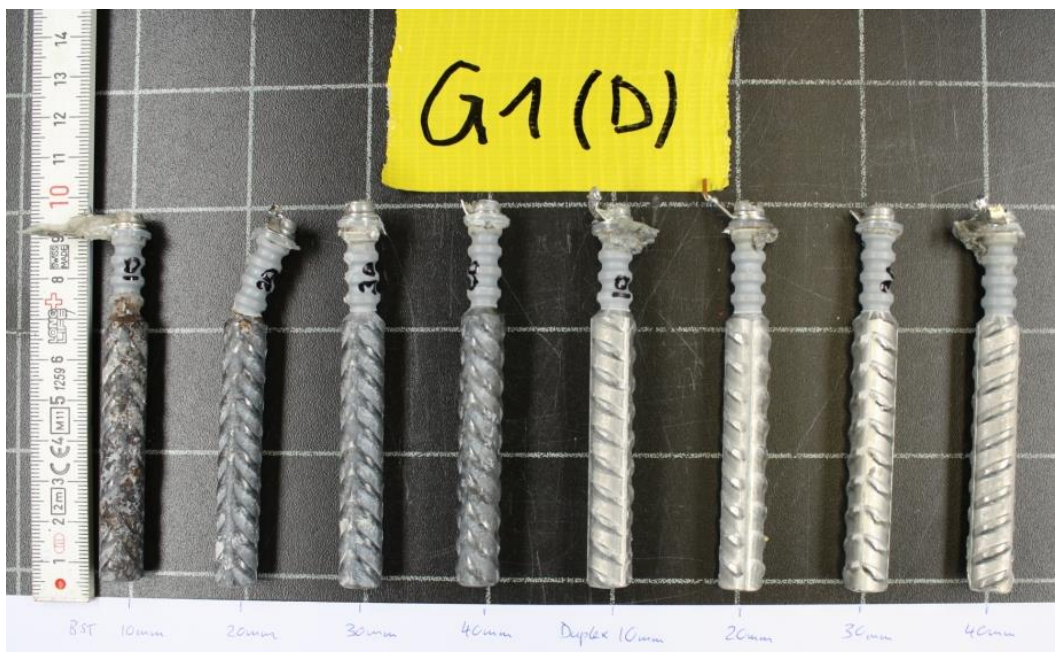
Abb. X-6 Korrosionszustand der Betonstäbe nach dem Ausbau 2012 in der Betonplatte G1 (Typ D). Von links nach rechts: 4 x Betonstahl (10/20/30/40 mm), 4 x Niro Betonstahl 1.4462 (10/20/30/40 mm).
